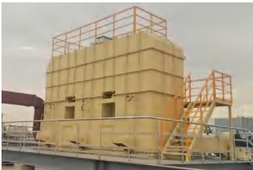
RCO 蓄热催化氧化实物图
