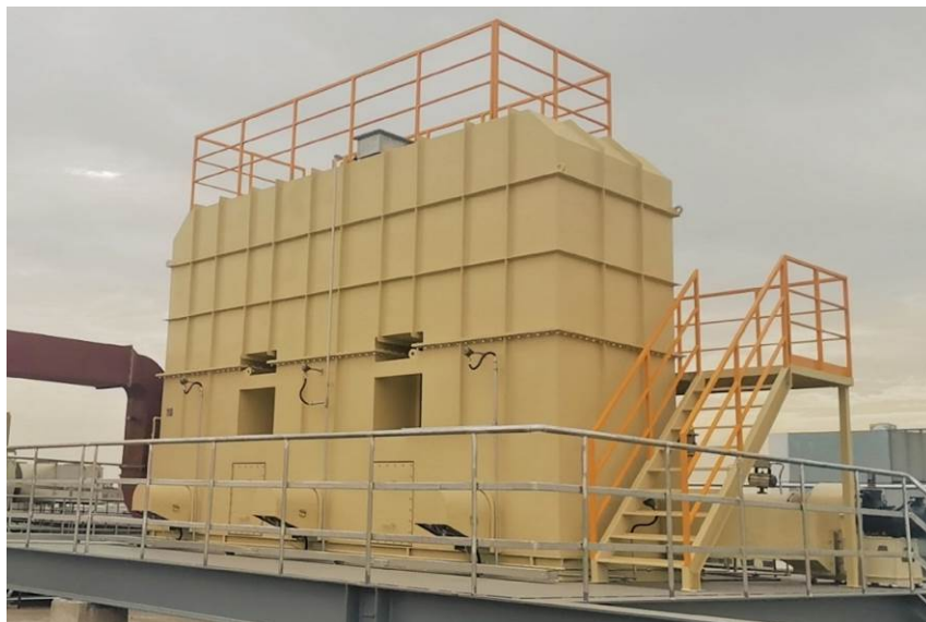
图 4.2-2 RCO 蓄热催化燃烧实物图
