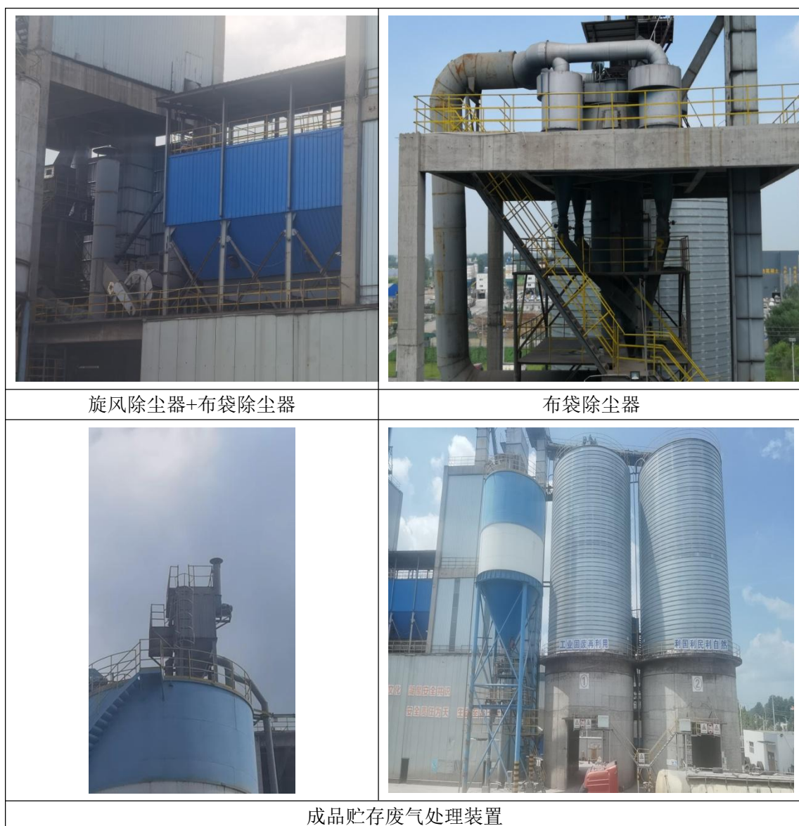
图 3.1.7-2 现有项目污染防治措施设施图
