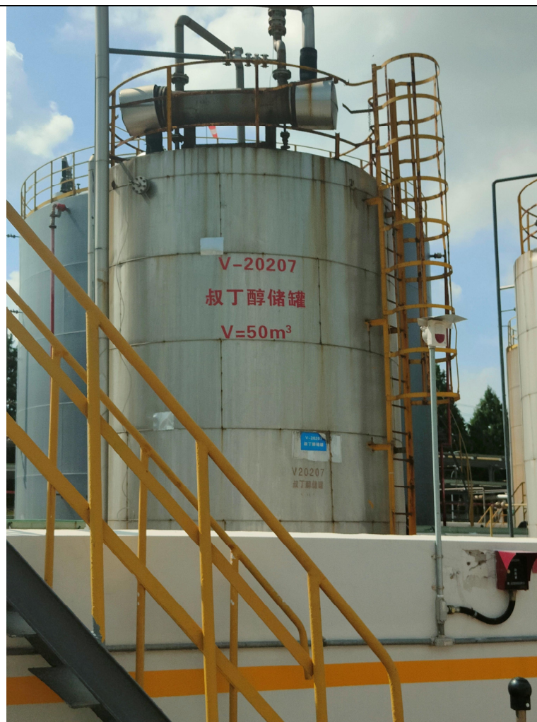
罐区废气收集设施
