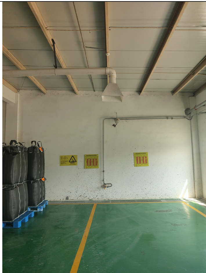
现有危废仓库废气收集设施
