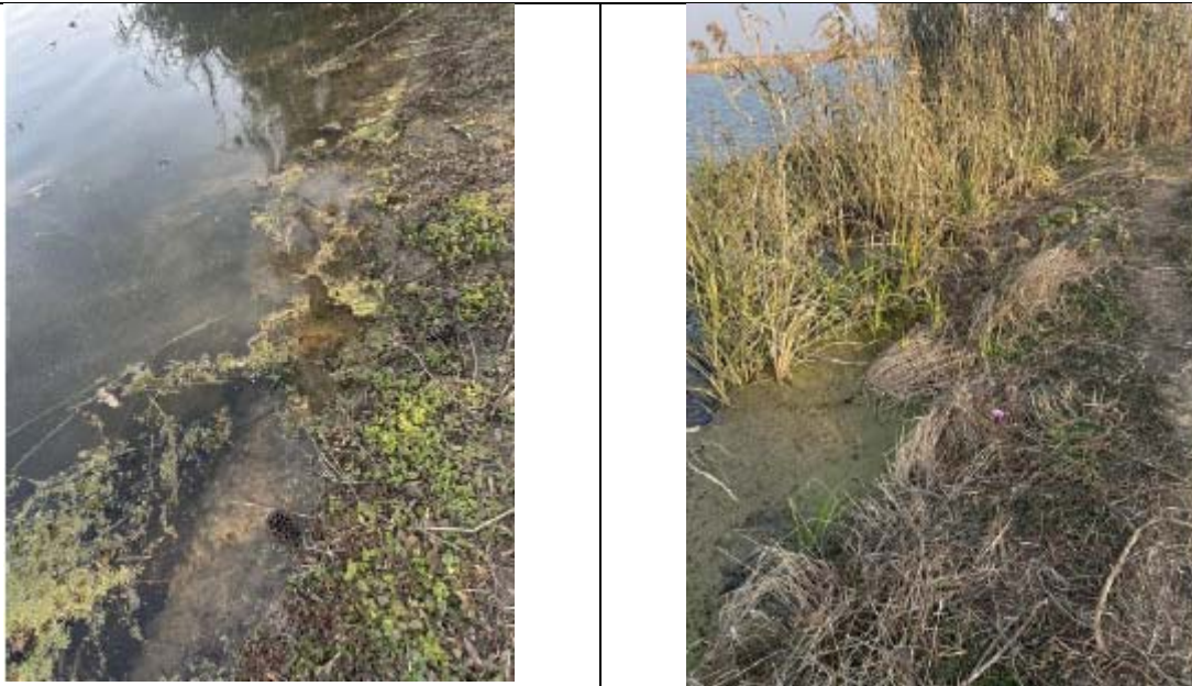
图2-3 现状受冲刷严重段岸坡照片-白马湖草泽河大桥东至朝阳河桥段
