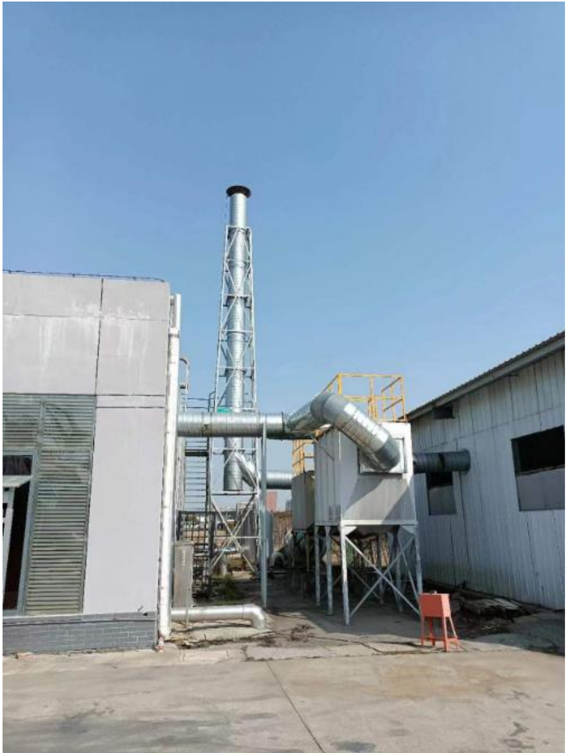
危险废物仓库废气收集与处理装置
